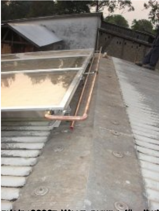
Blick auf Solarthermieanlage - Blick auf Solarthermieanlage - Blick auf Solarthermieanlage - Blick auf Solarthermieanlage - Blick auf Solarthermieanlage - Blick auf Solarthermieanlage - Blick auf Solarthermieanlage - Blick auf Solarthermieanlage - Blick auf Solarthermieanlage - Blick auf Solarthermieanlage
